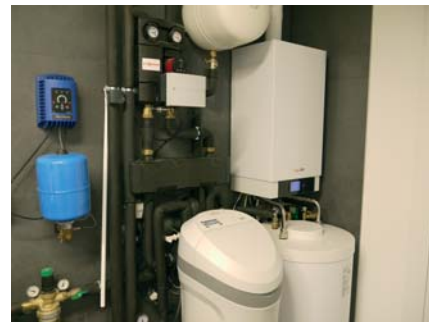
V technickom zázemí nájde kotel so zásobníkom TUV, frekvenčným meničom čerpadla pre zásobovanie úžitkovou vodou a vodnými filtermi.
