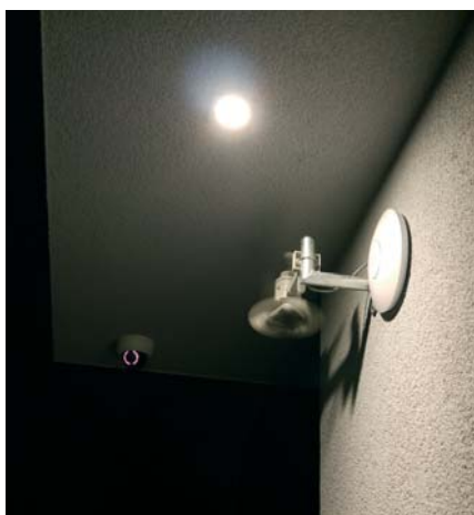
Vonkajšia meteostanica dáva Foxtrotu informácie predovšetkým o sile a smeru vetra a o vonkajšej teplote a vlhkosti vzduchu. Ten ich potom využije pre riadenie zvlášť vykurovania a žalúzií. Samozrejme je i zobrazenie týchto údajov na ľubovoľnom z pripojených tabletov.
